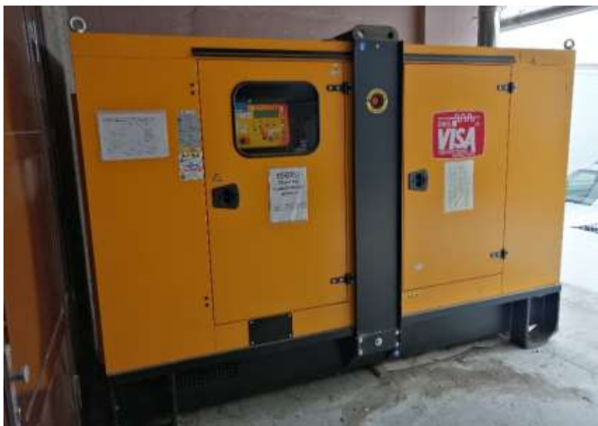
Obr. 106 Záložný motorgenerátor na nepretržité napájanie dátového centra GKÚ
